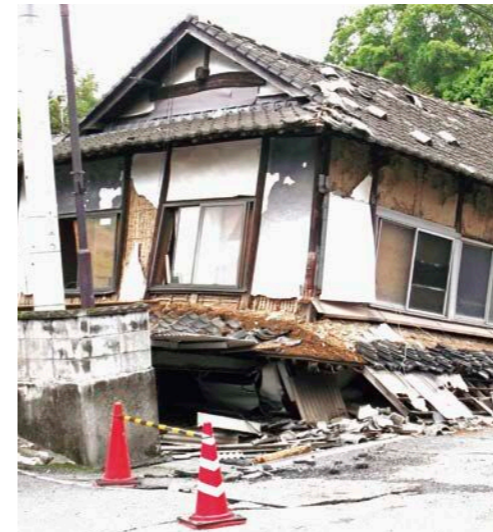
木造住宅倒壊の様子 Collapse of a wood-frame house
